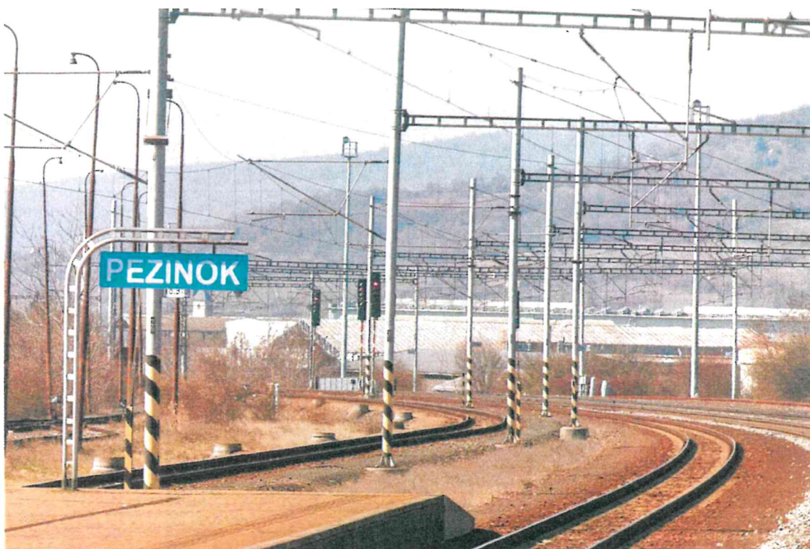
Fotografia č. 8: Prekrývanie odchodového návěstidla L2 stožiarom brány trolejového vedenia č.31 a súčasne odchodového návěstidla L4 stožiarom č.33, fotografované v km polohe 18,975, ŽST Pezinok, 19.3.2025
